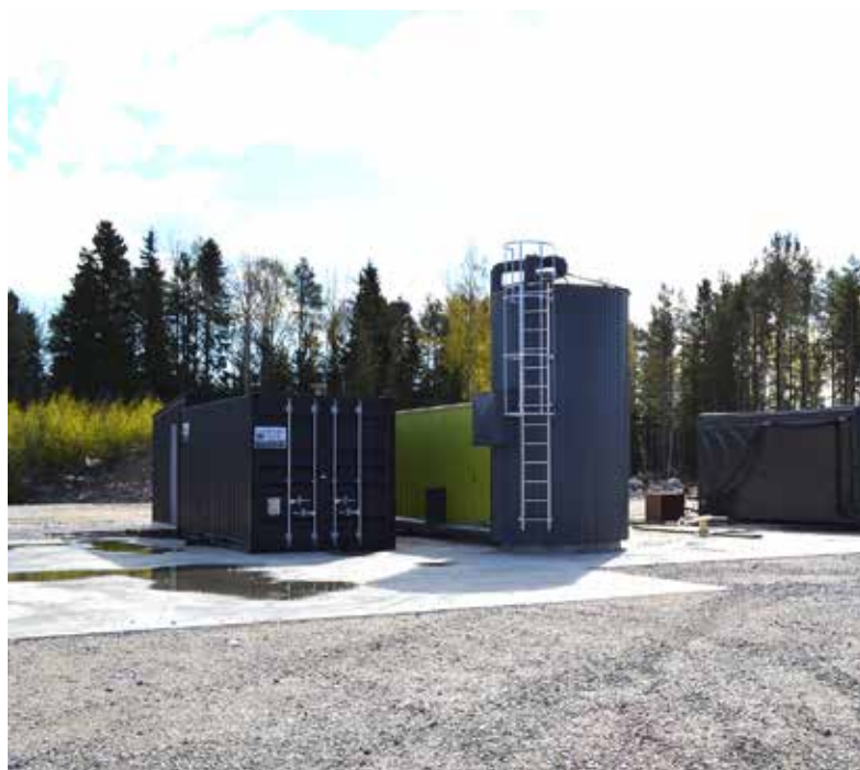
Biogasanläggningen på Långtå.
