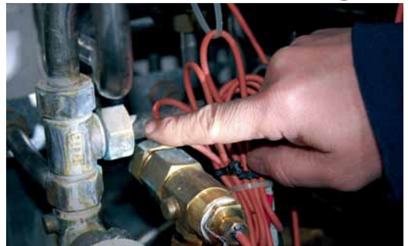
Ha för vana att mellan varven ta en titt på din fjärrvärmecentral. På så vis kan du lätt hindra att den går sönder.
