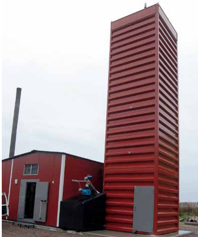
Den nya pellets pannan i Långrör är nu i drift.
