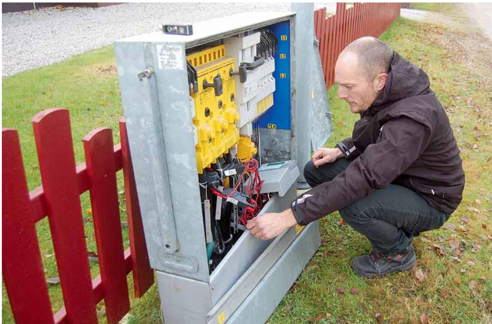
Henrik Inancsi fäster mätutrustning i ett kabelskåp.
