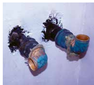
Allt som påminner om bergvärmen är två rör i väggen.
