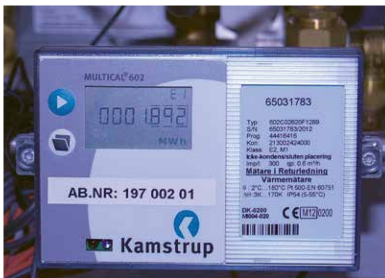
Med en enkel mätare kan man hela tiden kontrollera förbrukningen av fjärrvärme.
